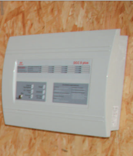
111 Hausalarmierungs- und Sprechanlagen
